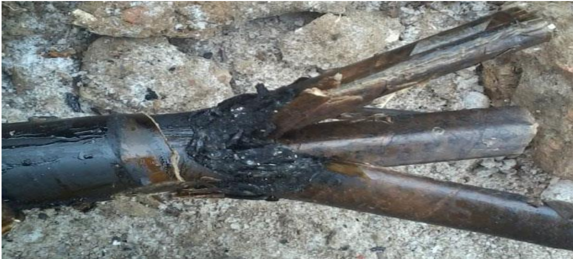
Рис. 1. Пробой изоляции высоковольтного кабеля
